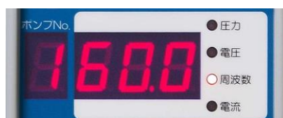
運転周波数表示 (例: 1号ポンプ 60Hz)
